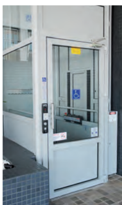
ELEVADOR PARA PESSOAS COM DEFICIÊNCIA
